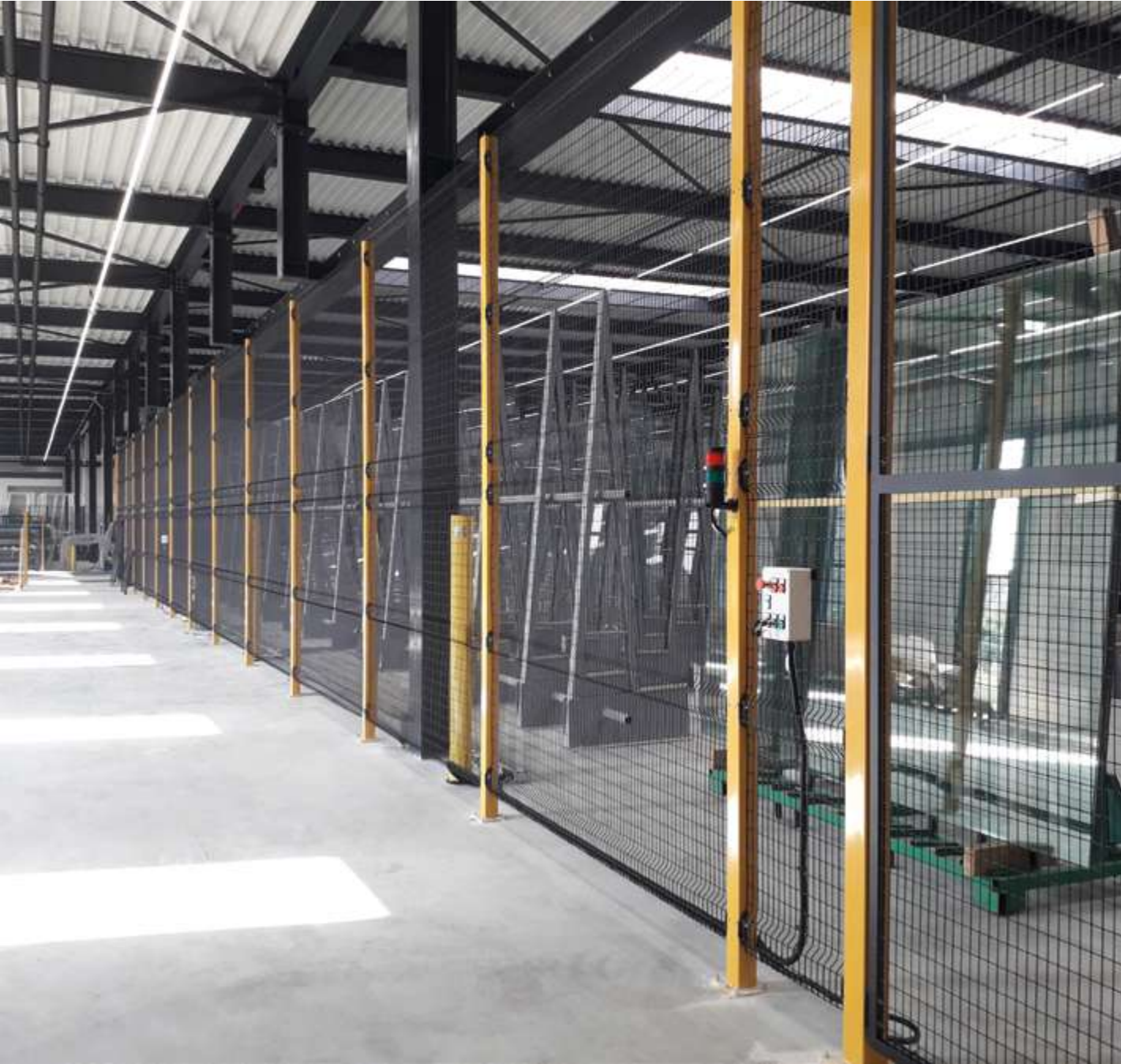
Ejemplo de aplicación del sistema Techno para la delimitación de zonas con manipulación de cargas a gran altura.
